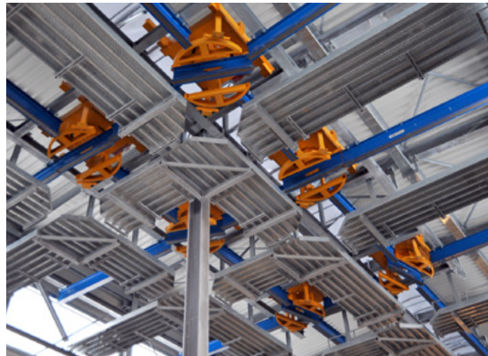
Die gelieferten Ingenia-Drehweichen, integriert im Monorailsystem, für eine optimale Materiallogistik. Bild: INGENIA GmbH
